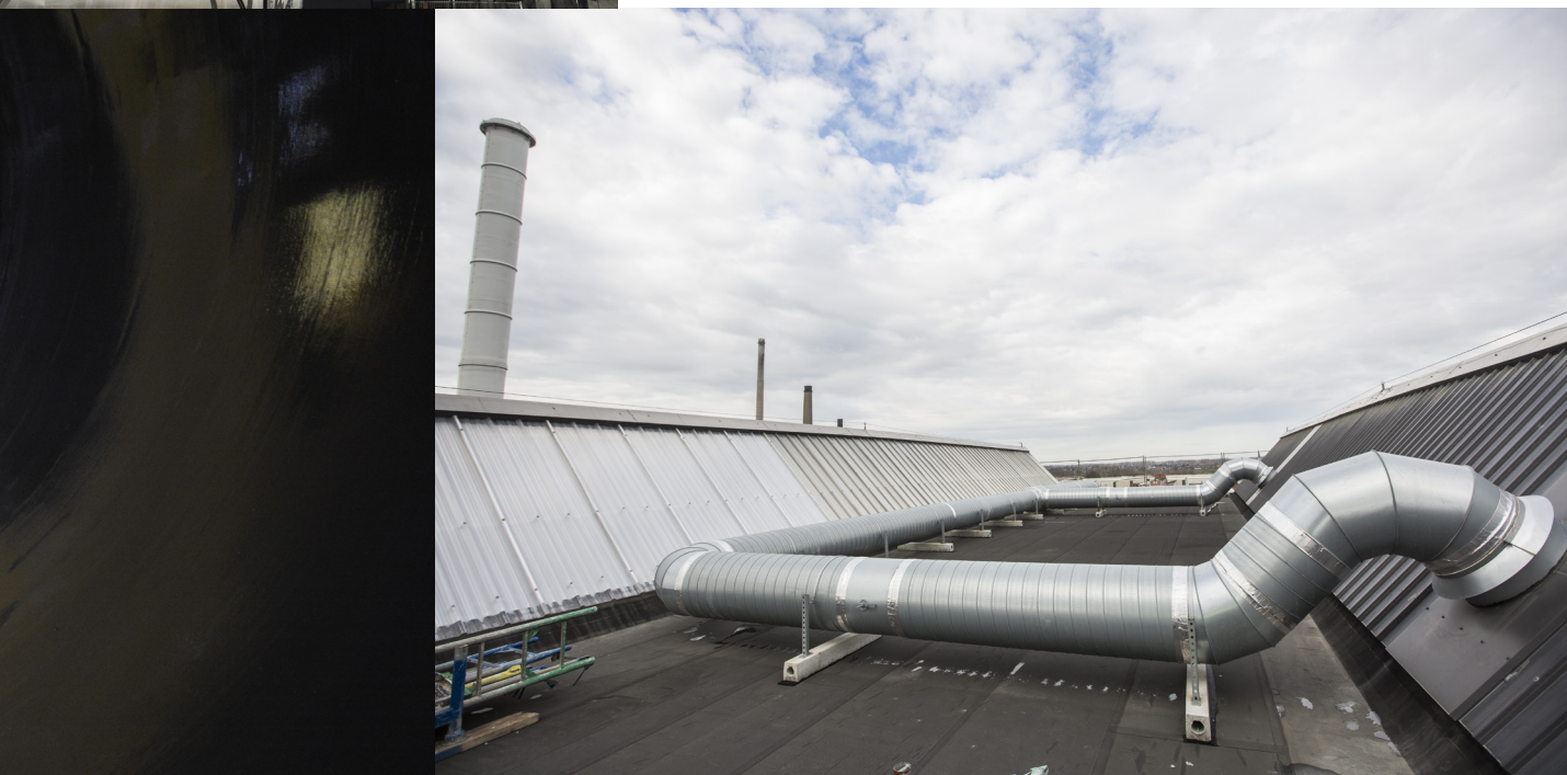
De voorlopige afzuiging op 2 dakkapellen van de loodraffinaderij.
