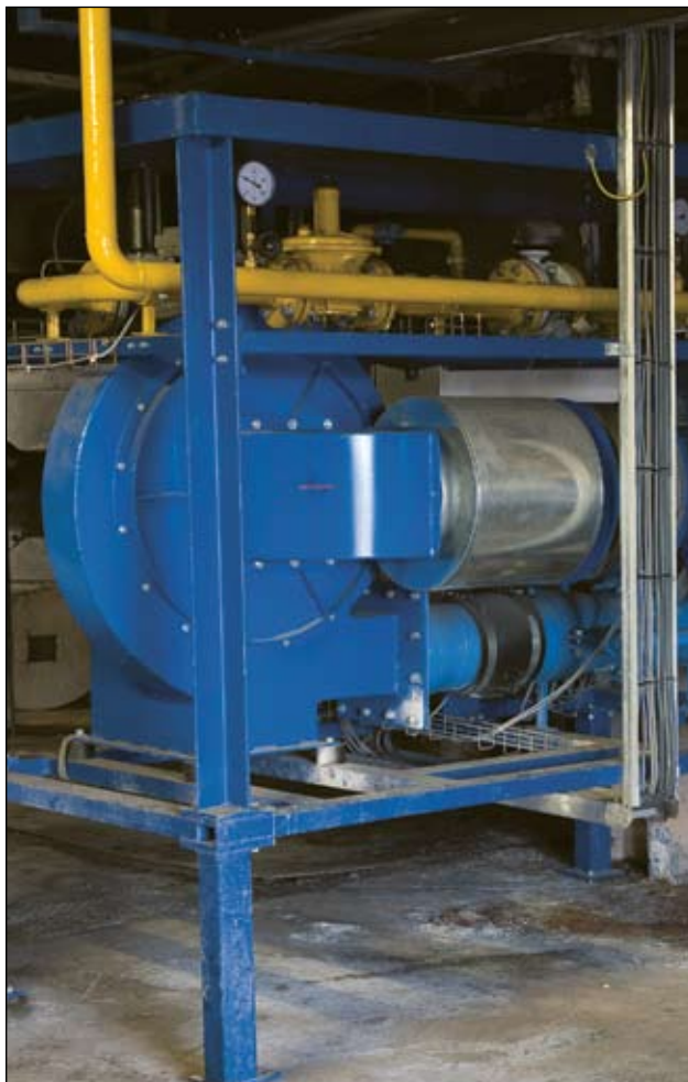
Nieuwe gasbranders in de Loodraffinerij
